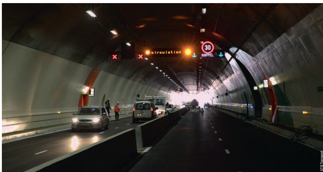
Photo 5 Exemple d'équipements en tunnel Example of tunnel equipment
