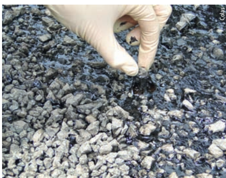
Photos 19 et 20 Rupture de l'émulsion
