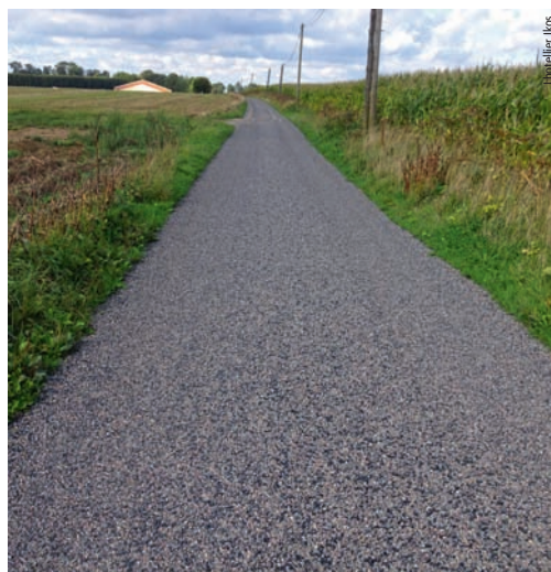
Photo 8 GE une fois revêtue par un enduit superficiel prégravillonné sur une voie communale de Grigneuseville dans la CCBE (76) GE roadbase once paved with pre-chipped surface dressing on communal roadway of Grigneuseville in Bosc d'Eawy CCBE (Seine-Maritime region)
