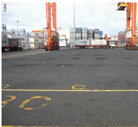
Photo 11 Dégâts causés par pied conteneur Damage caused by container base
