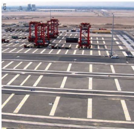
Photo 12 Exemple de plate-forme réalisée avec longrine en béton Example of platform made with concrete sills
