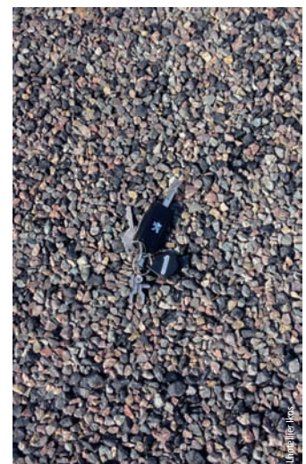
Photo 9 Gros plan sur l'enduit superficiel de type monocouche prégravillonné Close-up of pre-chipped single-layer surface dressing
