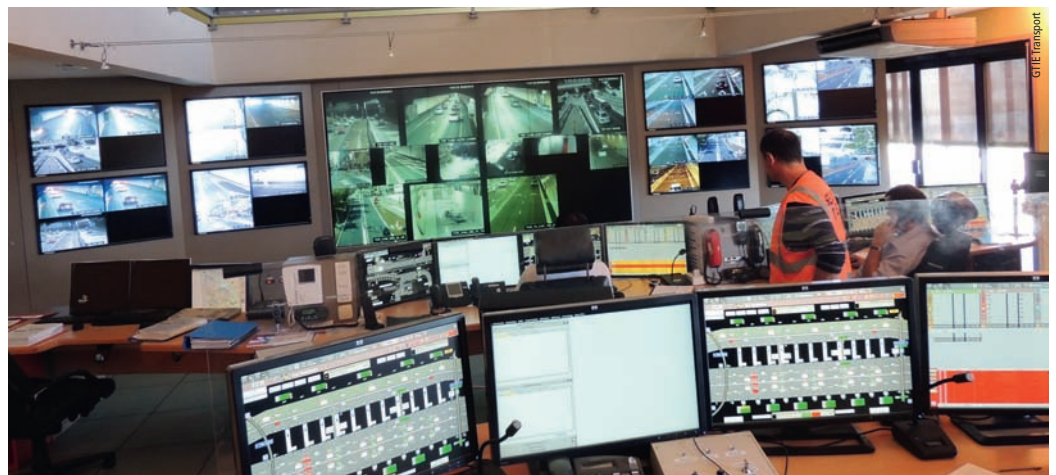
Photo 1 Le PC Comet au tunnel sous Fourvière Comet control centre for tunnel under Fourvière
