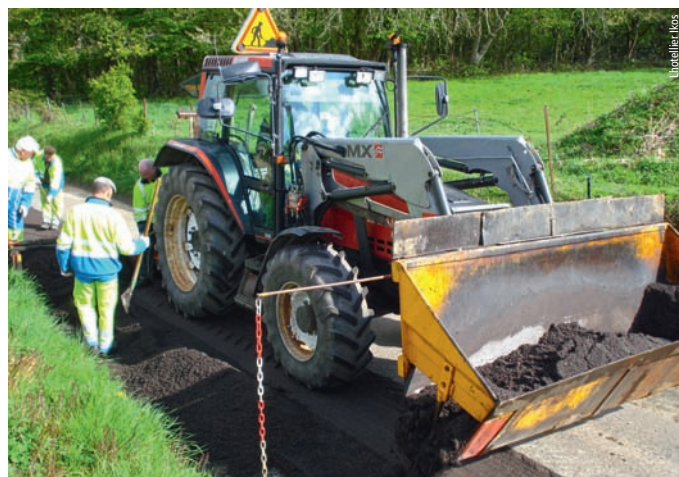
Photo 3 Dispositif de mise en œuvre de la CCAE, avec, sur l'avant du tracteur, le système d'alimentation dans lequel les camions déversent leur chargement de GE CCAE community laydown system with tractor-mounted feed into which lorries deliver emulsion-treated roadbase (GE)
