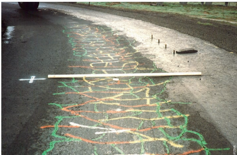
Chaussée expérimentale fissurée par fatigue Test pavement cracked by fatigue
