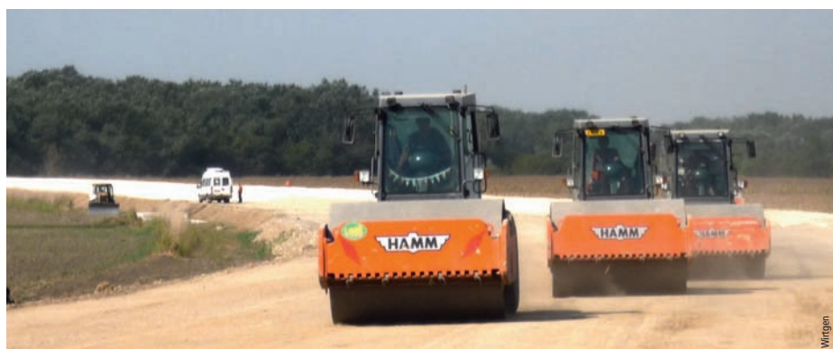
Des compacteurs Hamm 3520 équipés du système HCQ de mesure du compactage et de Hammtronic compactent la couche de fondation de l'A3
