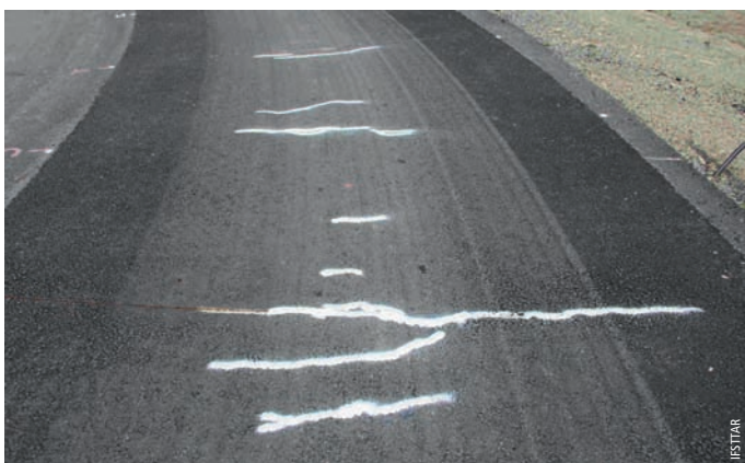
Photo 12 Evolution de la fissure à 520 000 passages Evolution of crack after 520,000 passages
