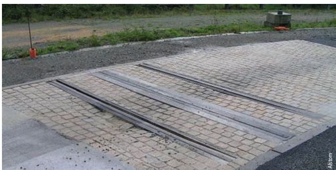
Photo 1 Poutre béton rail métallique revêtement en pavés endommagé Concrete beam, steel rail, paver surfacing damaged
