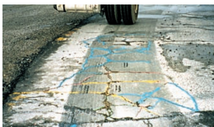
Fissuration d'une structure souple
