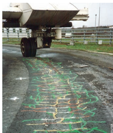
Photo 1 Fissuration de la structure 1 après 800 000 cycles (essais fatigue phase 3) Cracking of structure 1 after 800,000 cycles (Phase 3 fatigue tests)
