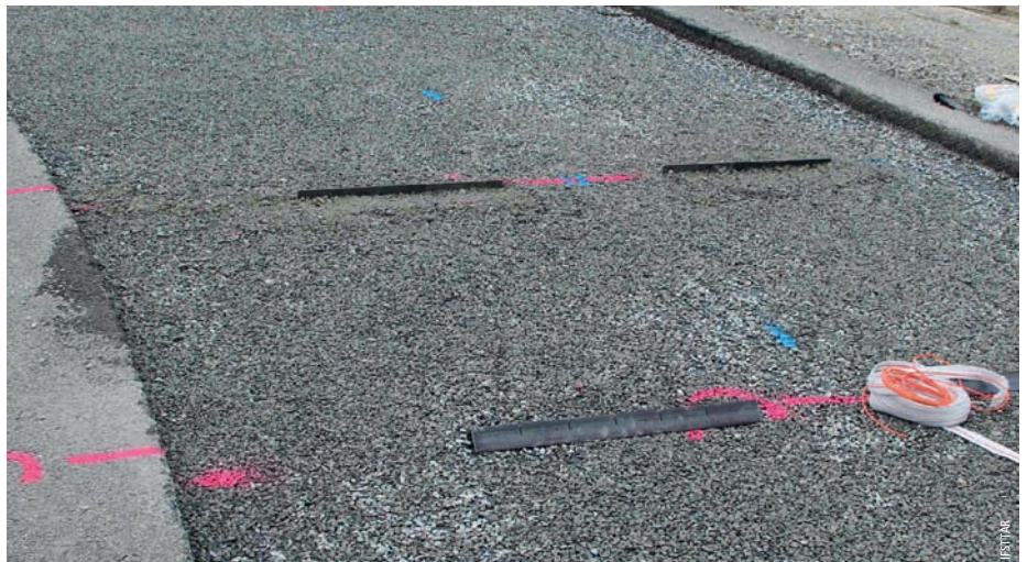
Photo 2 Cornières métalliques et barres en T fixées dans la grave Angle irons and bars in T form inserted in roadbase material
