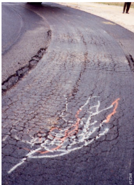
Photo 2 Dégradations liées aux infiltrations d'eau sur une chaussée à faible trafic, à assise en GNT polluée, sensible à l'eau (expérience de 1990)
