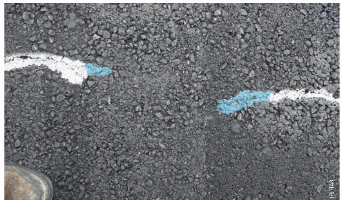
Photo 11 Evolution de la fissure à 450 000 passages Evolution of crack after 450,000 passages
