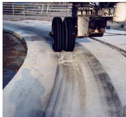
Photo 1 Première expérience sur chaussées béton (1991) ; dégradations au niveau d'un joint entre dalles non goujonnées
