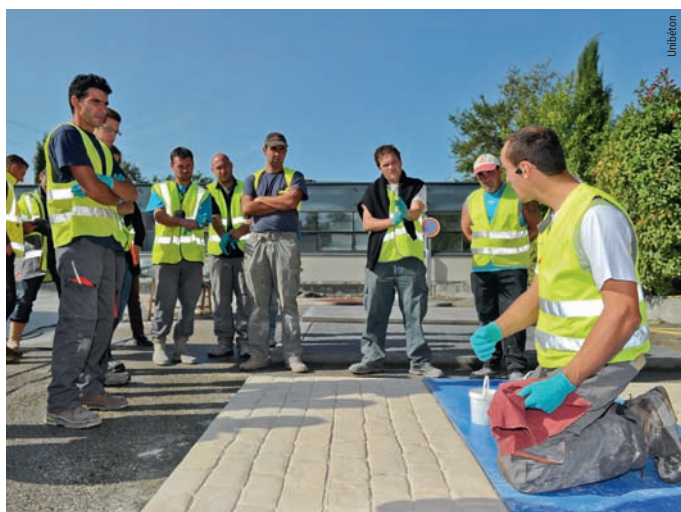
Les sessions de formation aux techniques de mise en œuvre du béton empreinte connaissent un vif succès auprès des professionnels
