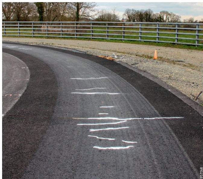
Dégradations obtenues à la fin de l'essai sur la structure instrumentée avec des fibres optiques continues End-of-test damage obtained on instrumented structure with continuous optical fibres
