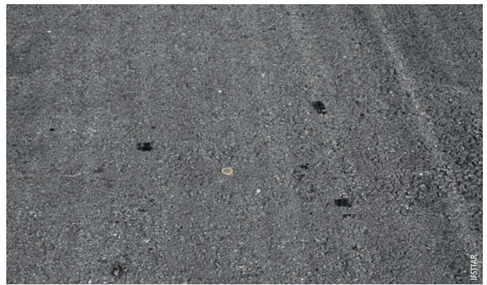
Photo 9 Evolution de la fissure à 300 000 passages Evolution of crack after 300,000 passages
