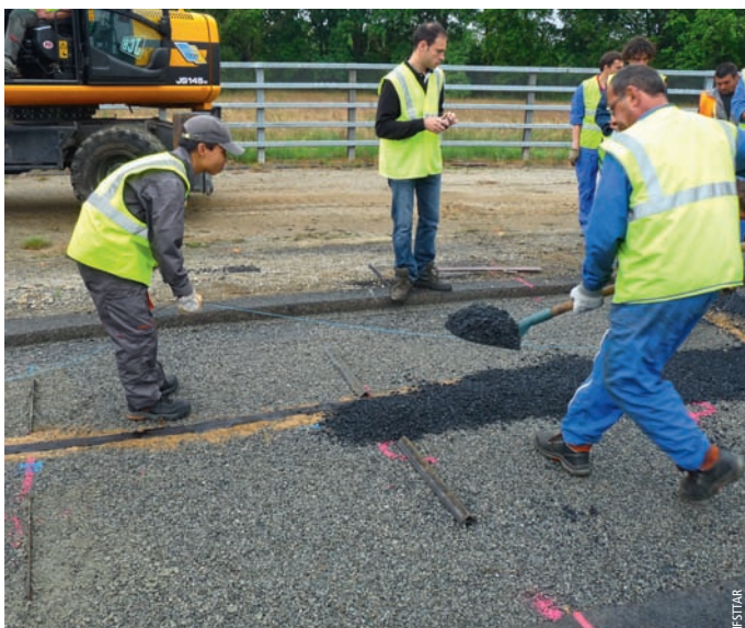
Photo 5 Réalisation d'un tapis d'enrobé et mise en place de la fibre Covering with asphalt mat and placing of fibre
