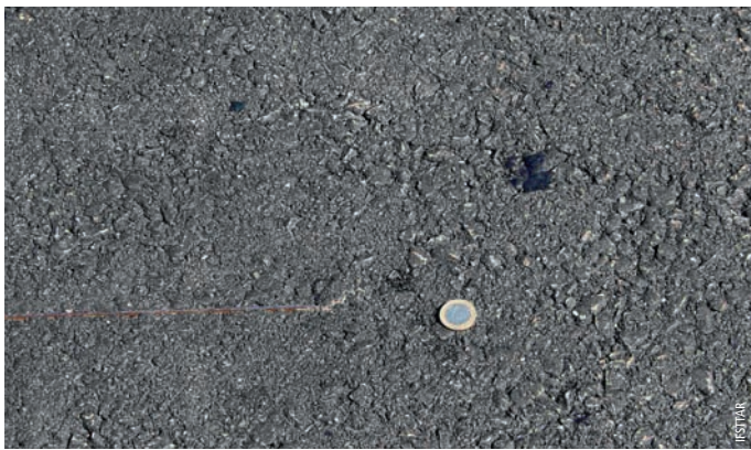
Photo 8 Evolution de la fissure à 250 000 passages Evolution of crack after 250,000 passages
