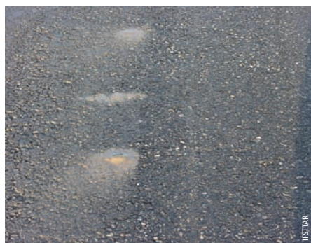
Photo 4 Remontée d'eau et d'émulsion due aux surpressions interstitielles générées par le trafic (Expérience du projet Format, 2004)
