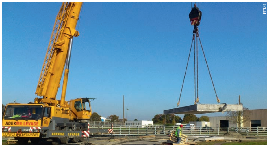
Photo 2 Mise en place d'une dalle à la grue sur le manège Crane placing a slab on circular test track
