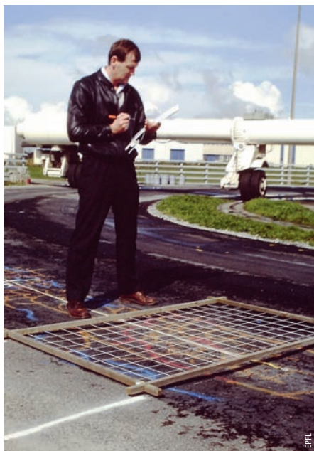
Photo 5 Relevé des fissures avant numérisation Recording of cracks before digitising
