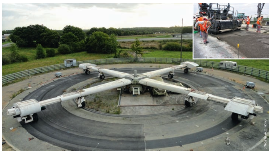
Photo 3 Vue d'ensemble des planches de l'expérimentation RECYROUTE et mise en œuvre par l'établissement Eiffage Travaux Publics d'Ancenis (44) General view of RECYROUTE trial sections applied by Eiffage Travaux Publics of Ancenis (Loire-Atlantique region)
