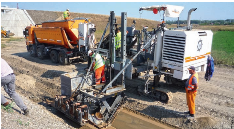
Après avoir posé une sous-couche de sable, la SP 250 pose la couche de béton selon le profil voulu sous la machine entre les trains de chenilles
