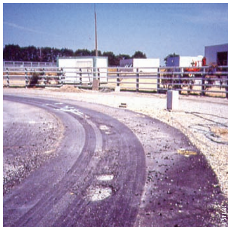
Photo 3 Formation de nids-de-poule suite à l'accumulation d'eau à l'interface entre l'assise en matériau traité au liant hydraulique et la couche de roulement
