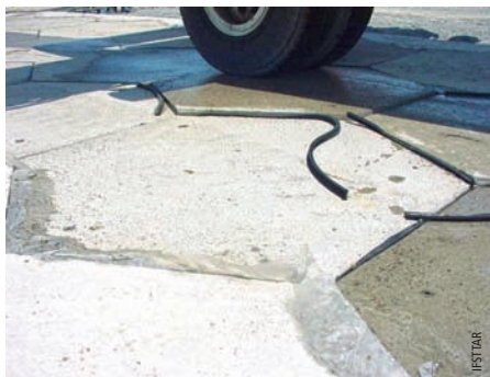
Photo 1 Extrusion du joint préfabriqué liée aux mouvements des dalles sous chargement
