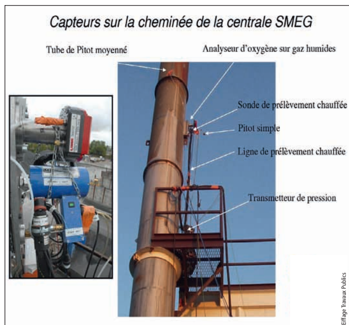
Instrumentation pour mesures environnementales sur la centrale SMEG
