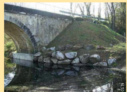
Photo 2 Passages à loutre sur la RD 164
